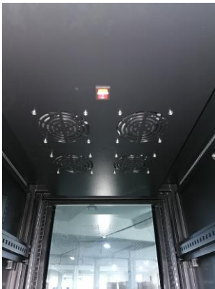
Top fan trays for ventilation
