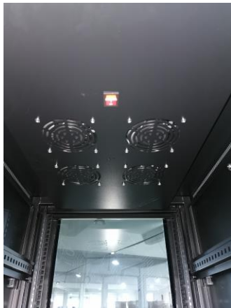
Top fan trays for ventilation
